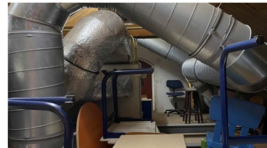
De ventilatie-units zijn geplaatst op de zolder van school 1939 en op de dakvlakken van de uitbreidingen 1981 en 2007 (buitenopstelling).
