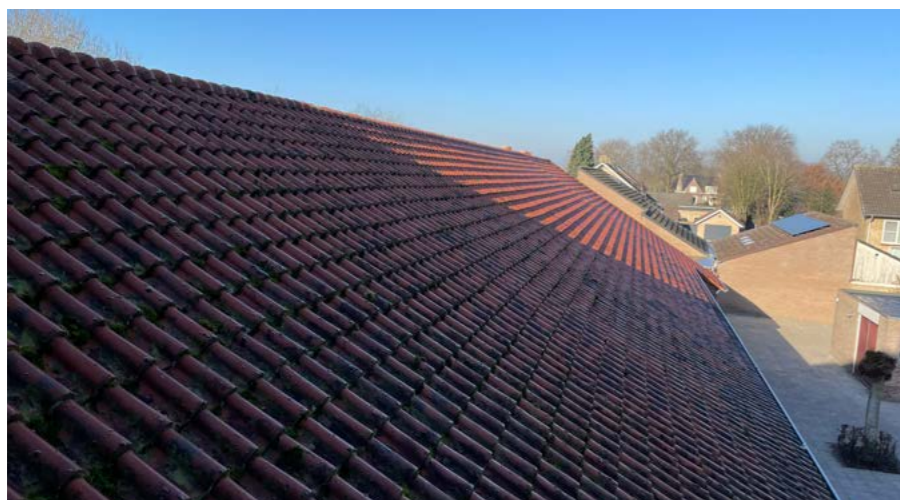
De gordingen zijn in het verleden versterkt, echter de doorbuiging is daarbij niet hersteld wat zichtbaar is over de pannenlijn.
