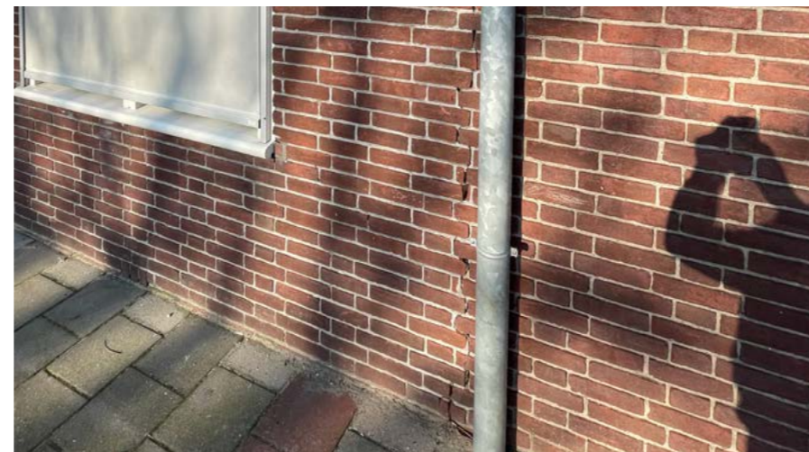
Enkele verticale scheuren in de gevel zijn toe te wijzen aan de later aangebrachte uitbreiding met één klaslokaal.
