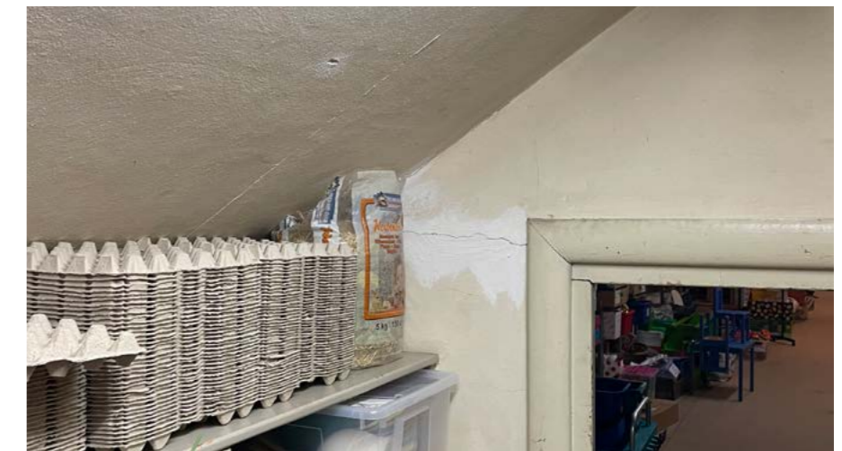
Op een enkele scheur in de binnenwanden na, is de technische staat van de metselwerk wanden redelijk tot goed te noemen.
